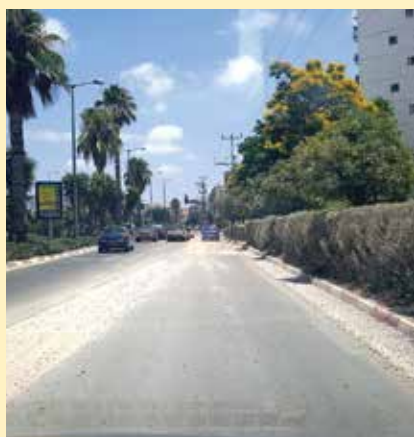
דרך הים | בקטע הרחובות משה פריד - רוז'נסקי עמיאל (בצד הדרומי) החלפת קו מים וריבוד
